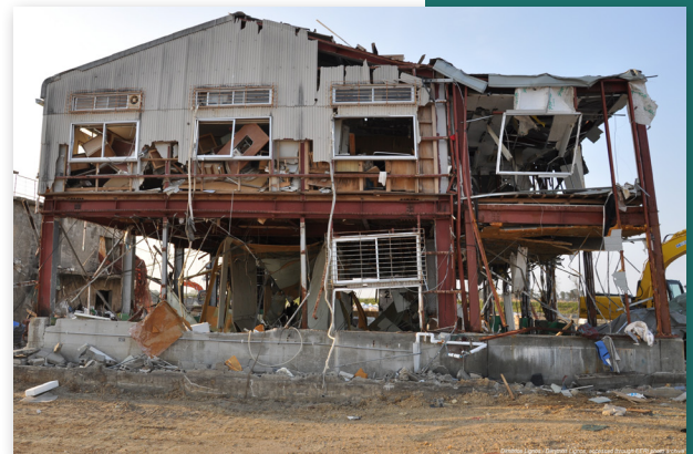
Los temblores del terremoto seguidos del tsunami dañaron tanto la armazón de acero como el armazón de acero de sujeción de este edificio.
