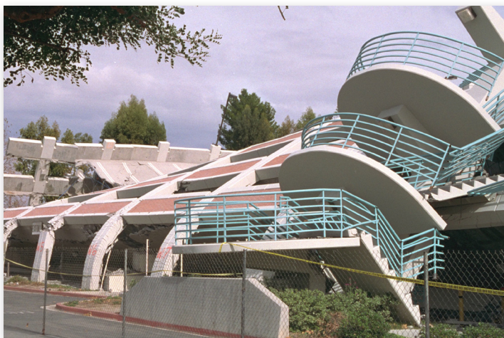
Los pilares de hormigón con armadura de confinamiento inadecuada fallaron durante el terremoto de Northridge de 1994.
